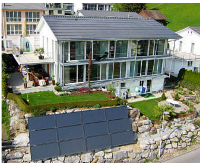
Das Haus in Mangelegg hatte zu wenig Fläche, weshalb die thermische Anlage neben dem Gebäude platziert werden musste. Später wurde noch eine Photovoltaik-Anlage auf das Dach montiert.
